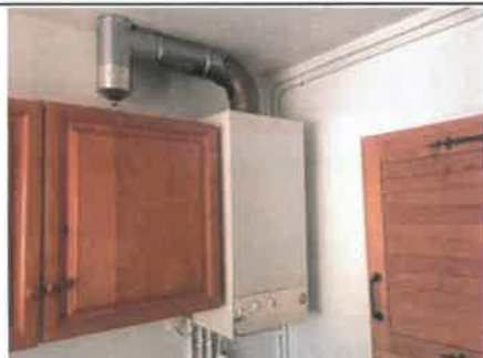
Photo n° PhGaz001 Localisation : RDC - Cuisine Chaudière e.l.m. leblanc (Type : Raccordé) Localisation sur croquis : Point001
