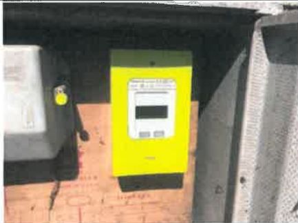
Photo du Compteur électrique
