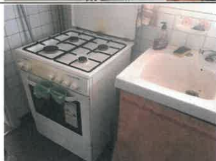
Photo n° PhGaz002 Localisation : RDC - Cuisine Cuisinière NV (Type : ) Localisation sur croquis : Point002
