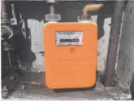
Photo n° du Compteur Gaz
